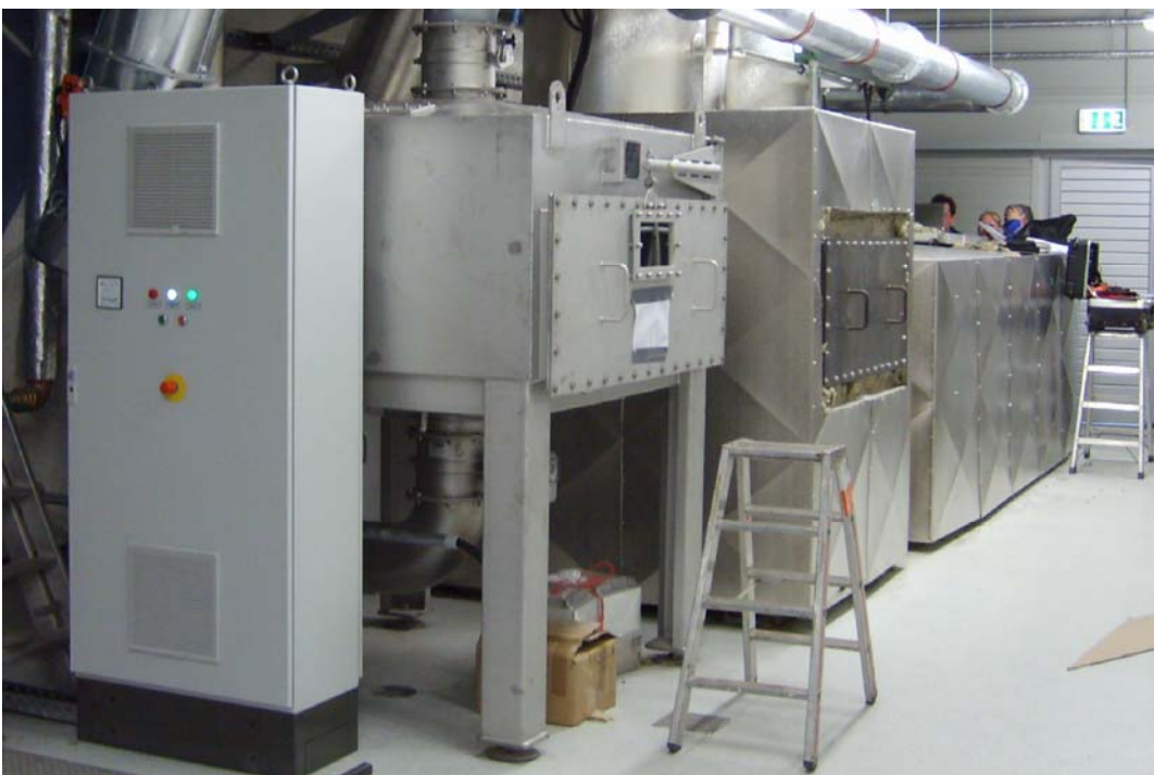
Bild 11: Katalytisch gestützte NTP-Anlage für ca. 10.000 \text{ m}^3_{\text{N}}/\text{h} Abluft nach der Aromatisierung von Lebensmitteln
